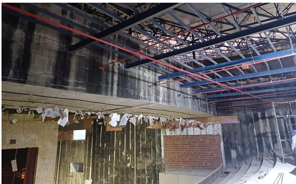
Tubos de combate a incêndio no palco
