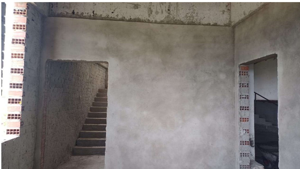
Camada de reboco na antecâmara – Lado Brasil
