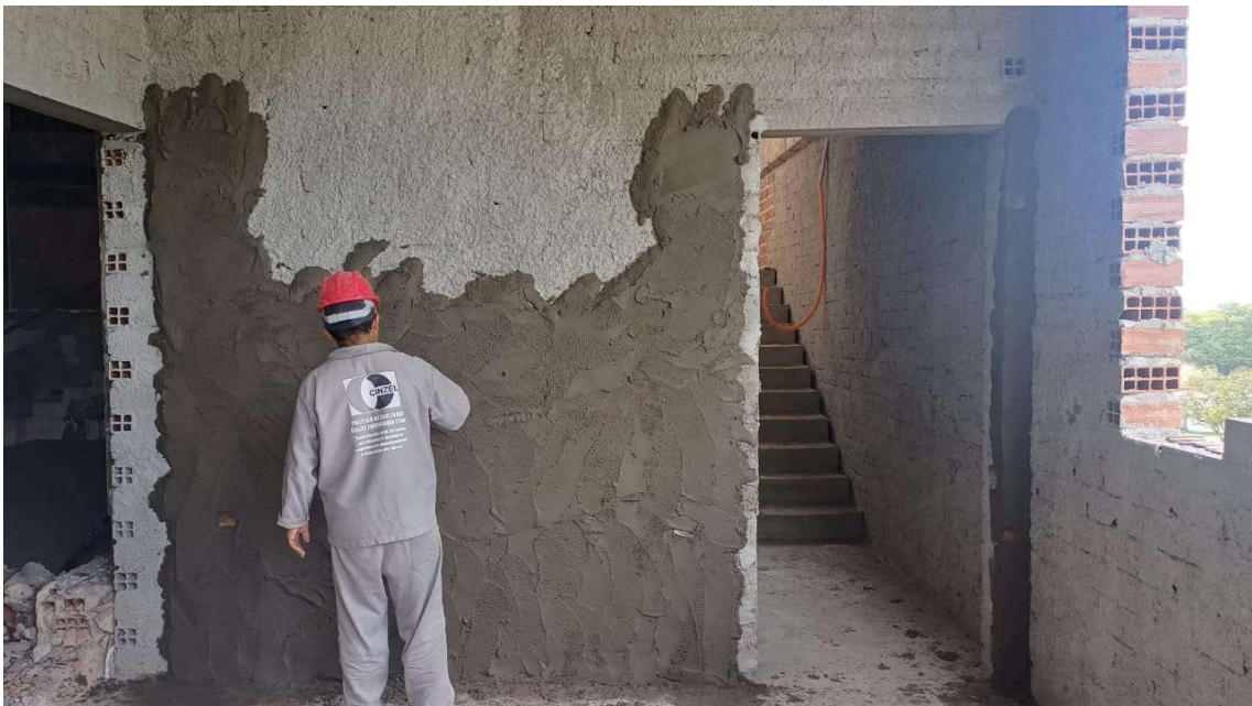
Camada de reboco na antecâmara – Lado Paraguai
