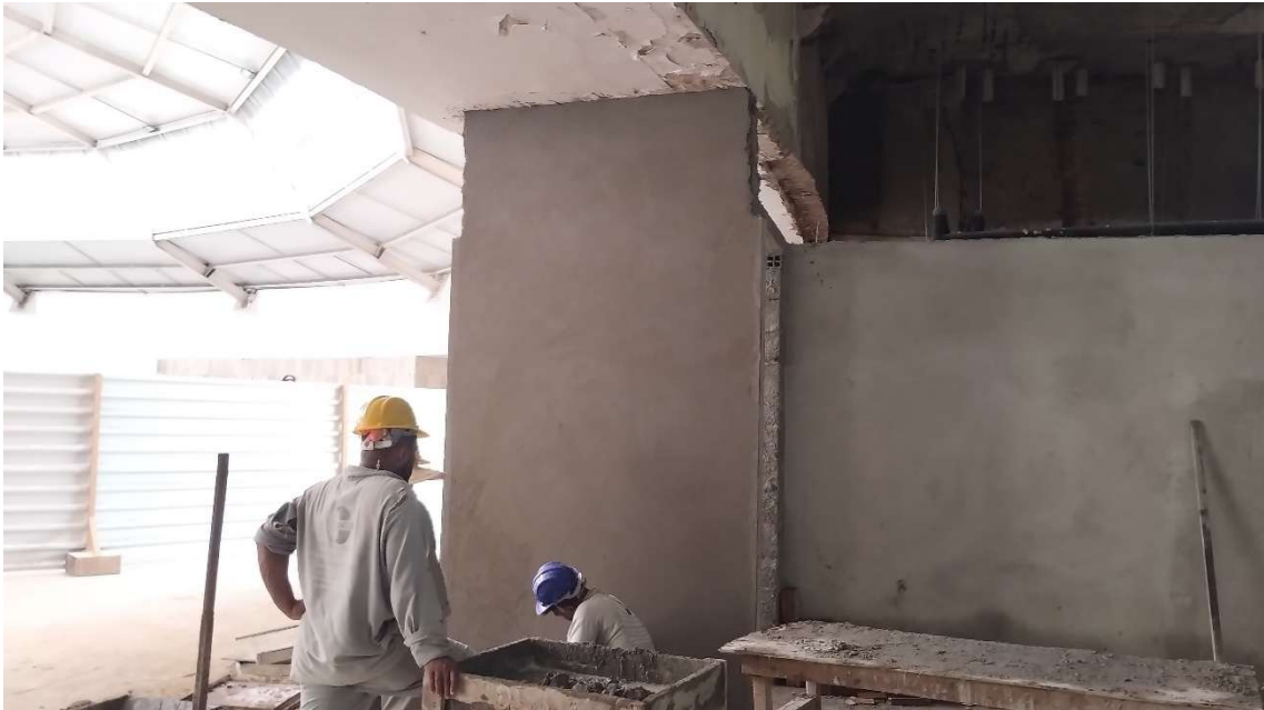
Camada e reboco na bilheteria
