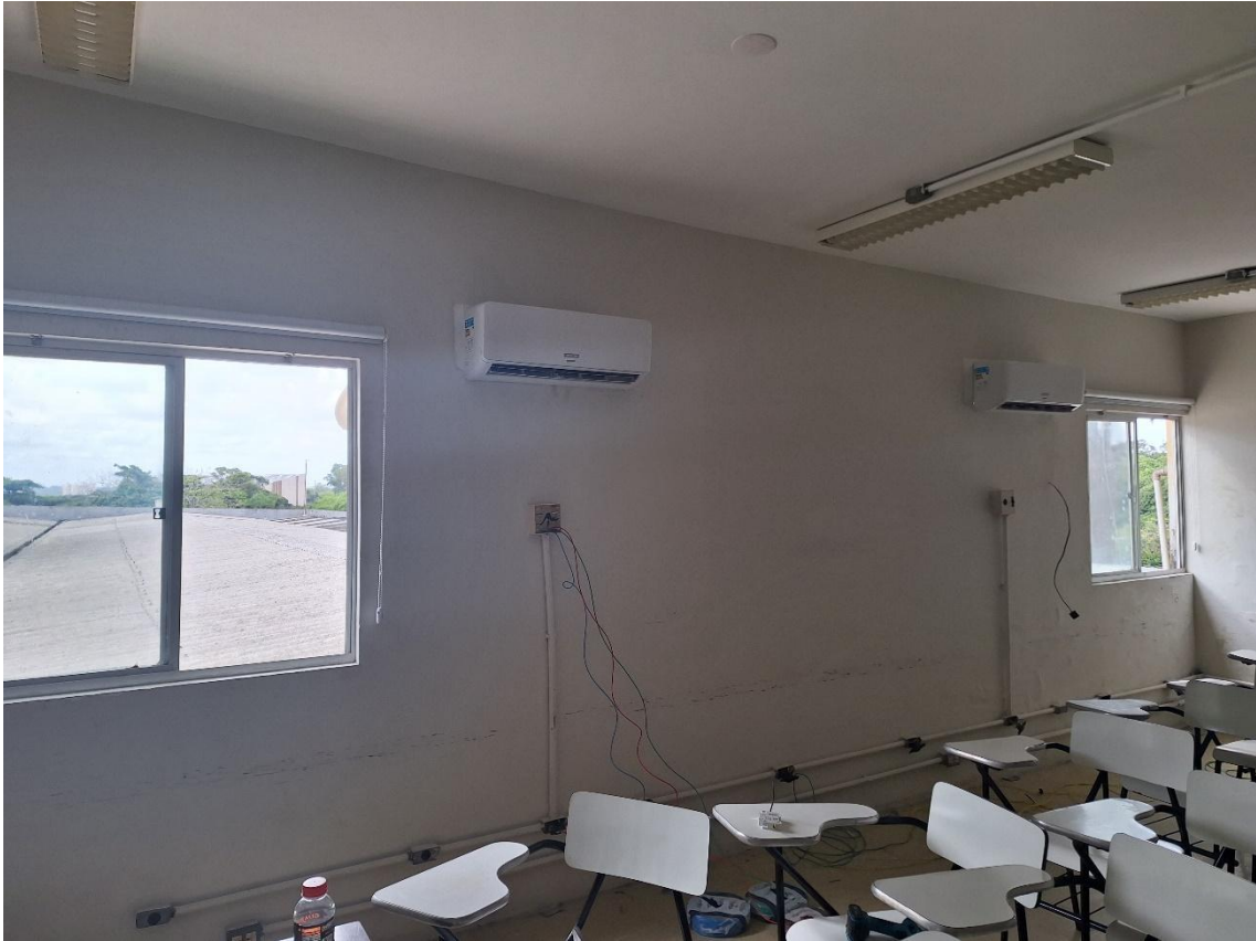
Instalação dos Astop dos ar condicionados e nas outras salas do 4º andar.
