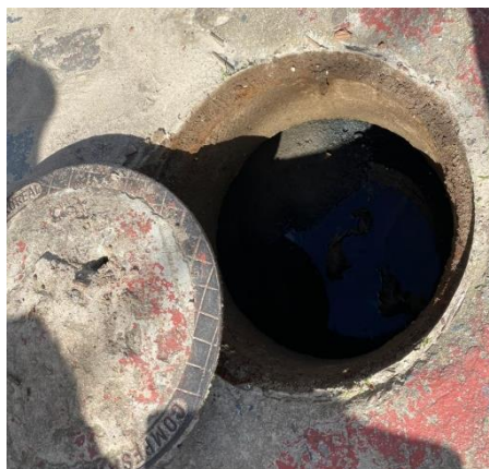
Figura 36: Poço de Visita cheio de esgoto
